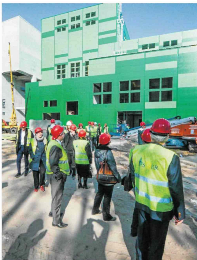
► Z zewnątrz budynek spalarni wygląda jak zwyczajny zakład. W środku jednak ma urządzenia, o które trudno w innych
